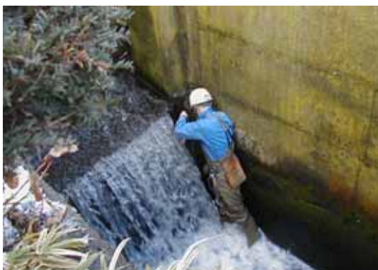
図1 水車設置場所
